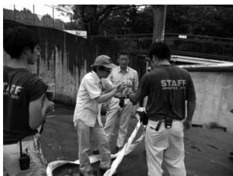
ヒヒの城での消防ホース設置
