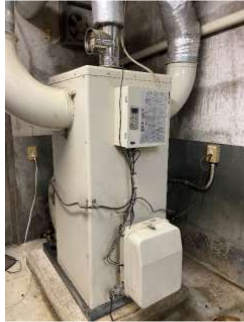
現在使用している動物病院の暖房機非常に古く、部品の生産も終了しているため、故障すると直すことができません。
